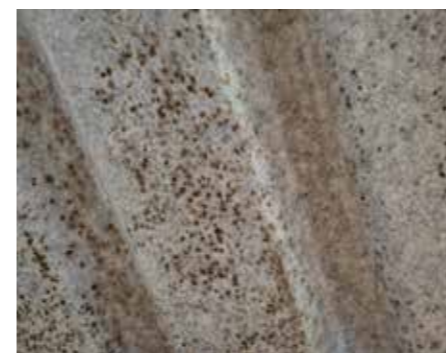
Vliesbeschichtung mit Schimmelbildung durch unzureichende Lüftung (Beispiel)
